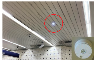
光警報装置（点滅時）
