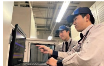
発車標制御装置確認
