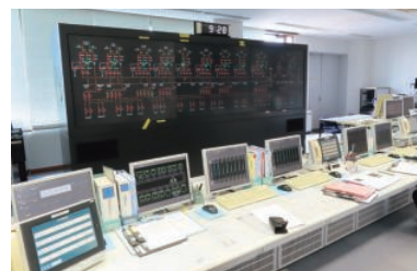
電力管理システム
