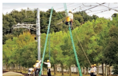
架線断線復旧
