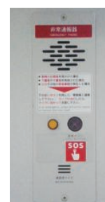
車内の非常通報器
