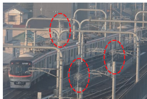
守谷駅に設置している電荷放散器
