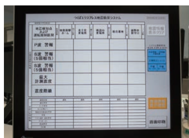
早期地震警報システムモニター (沿線地震計)
