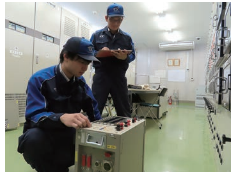
ロケータ設備点検
