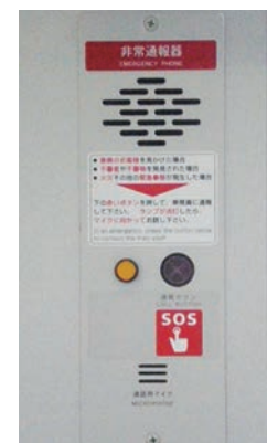
車内の 非常通報器
