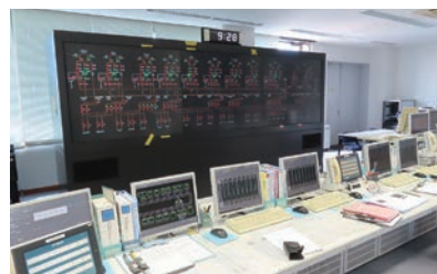
電力管理システム
