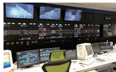
運行管理システム設備
