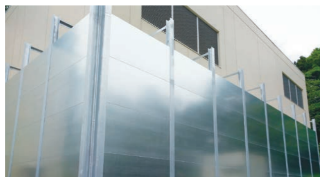
南流山変電所の防音壁
