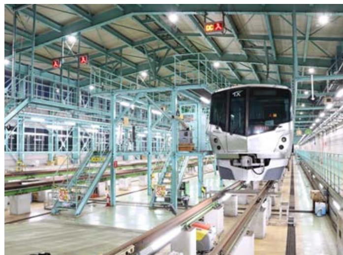
LED照明に交換された検車庫
