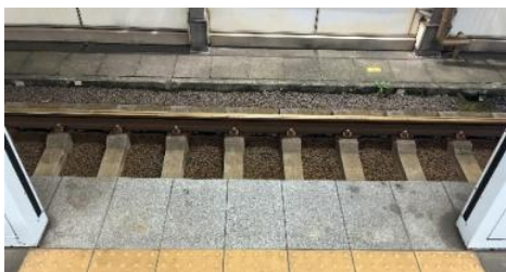
ホーム隙間対策前
