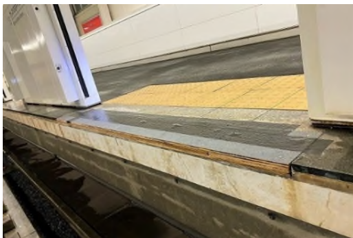
ホーム隙間対策前
