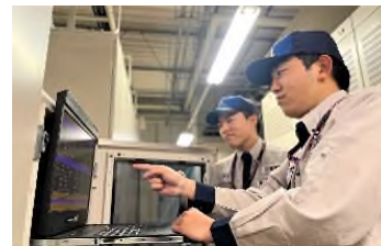
発車標制御装置確認
