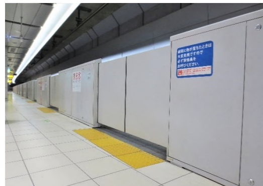
ホームドア（地下駅）
