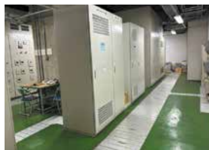
直流電源装置
