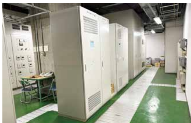
直流電源装置
