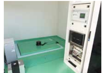
TX早期地震警報システム(地震計)
