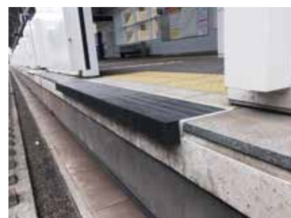
駅ホームの隙間対策ゴム
