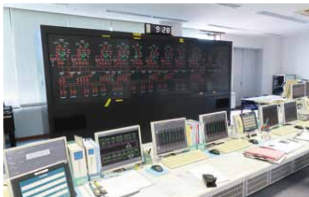
電力管理システム
