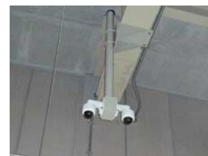
変電所内の監視カメラ
