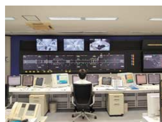
運行管理システム設備
