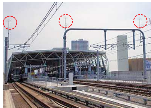
守谷駅に設置された電荷放散器
