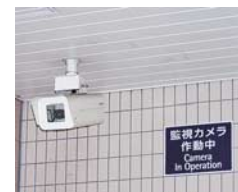
駅構内の監視カメラ
