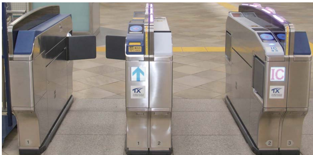
全20駅に設置完了した新型自動改札機
