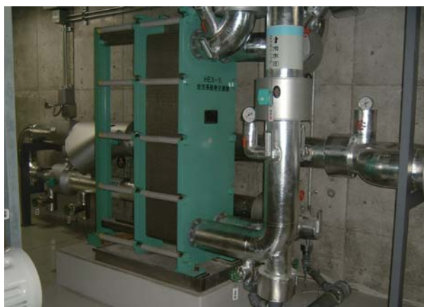
地域冷暖房設備 （受給した冷水から空調用自社冷水を作る装置） 「つくば駅」
