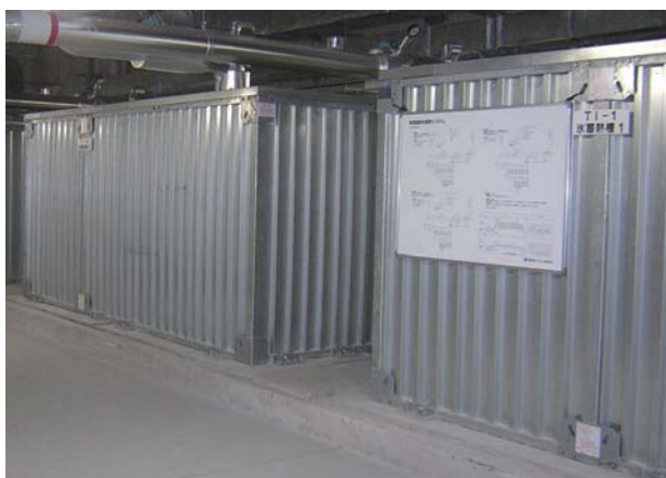
氷蓄熱槽（冷水で作った氷を蓄える槽） 「秋葉原駅」
