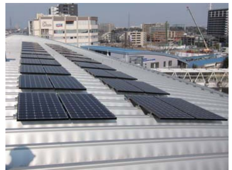
太陽光パネル
