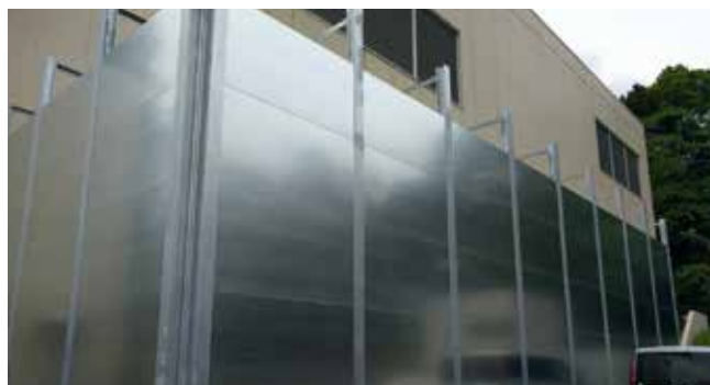
南流山変電所の防音壁
