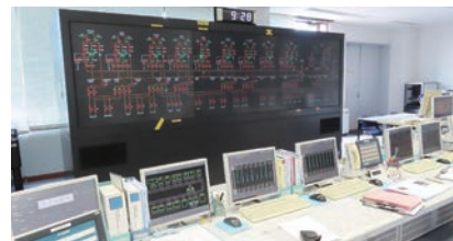
電力管理システム
