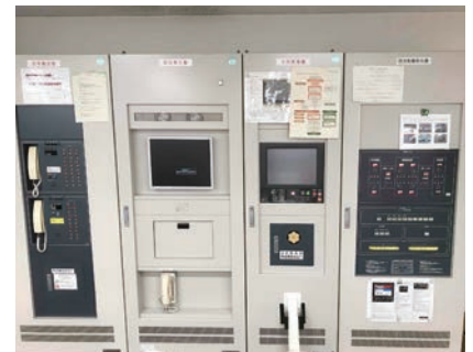
駅防災設備盤
